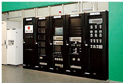
稼働を開始したEMS装置
